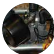
Фильтр на входе воздуходувки
