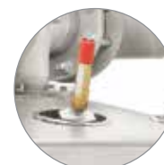
Предохранительные клапаны резервуара
